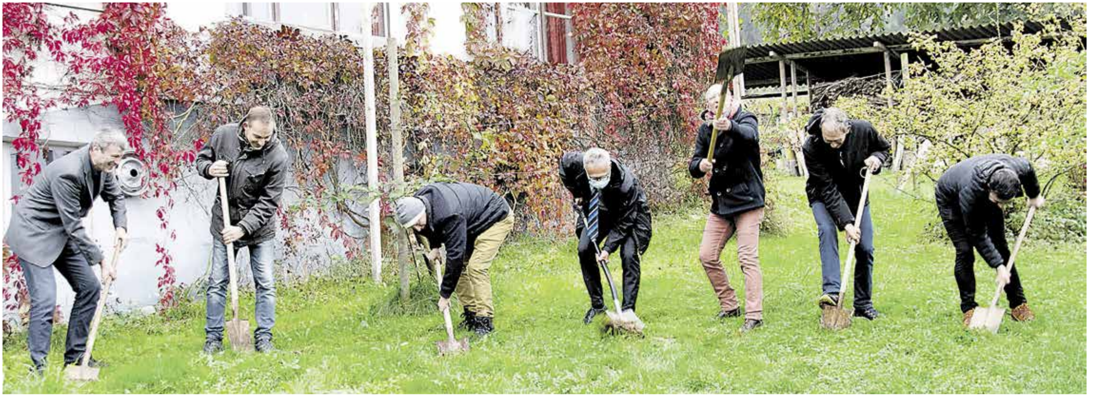
Architekt, Kantons- und Gemeindevertreter graben beim offiziellen Spatenstich mit Heimleiter Hebing um die Wette.
